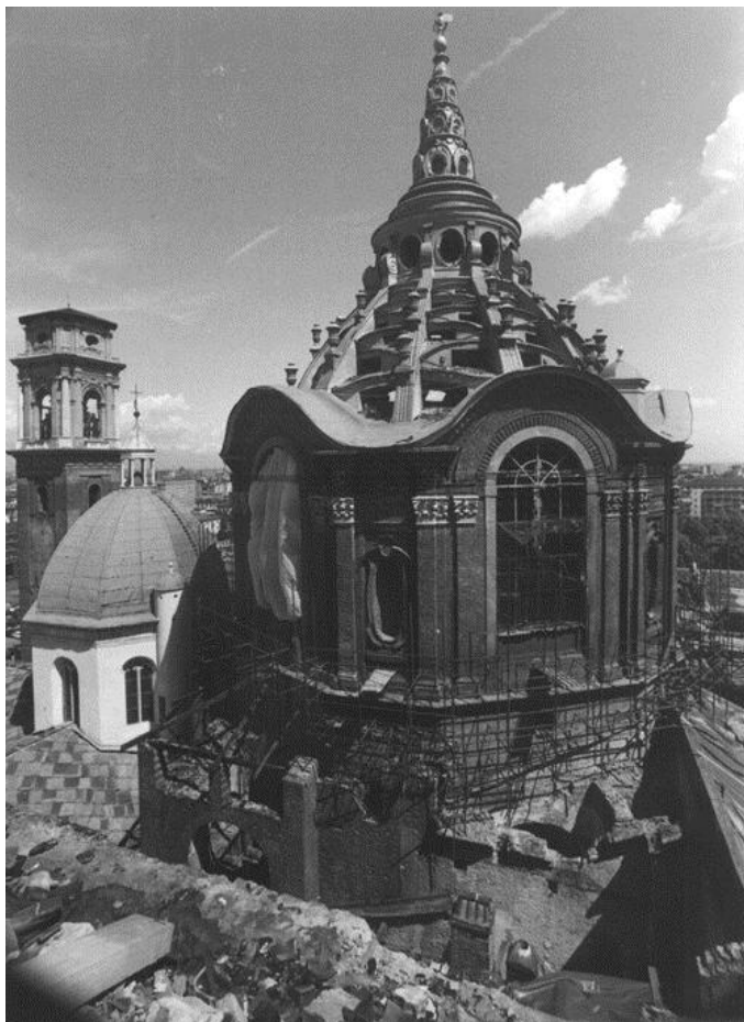
Figura 1: Danni alla cupola e al tamburo dopo l'incendio. Credits Archivio fotografico Soprintendenza ABAP di Torino.
